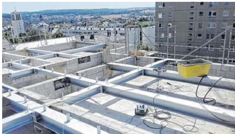
Ein Stahltragrost als wesentlicher Faktor für die Aufstockung: Diese Konstruktion trägt die zwei Obergeschosse und die Balkons.
