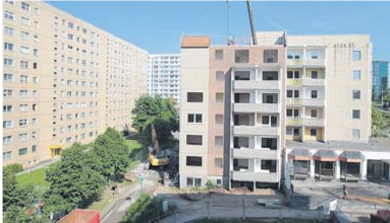
Dieses Wohnhaus zwischen Bahnhof- und Tischendorfstraße wird abgerissen. Die WBG will außerdem die angrenzende Häuserzeile umgestalten.
